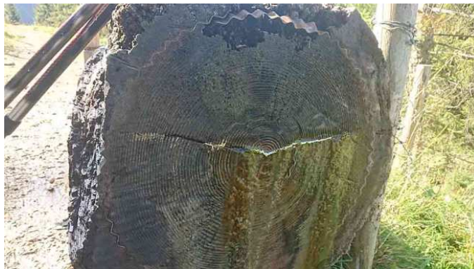
Abbildung 70 Viehtränke bei der Strausbergalpe unterhalb des Imberger Horns nahe Bad Hindelang im Allgäu. Sie leckt trotz Wellbandeisen und ständigem Feuchthalten.
